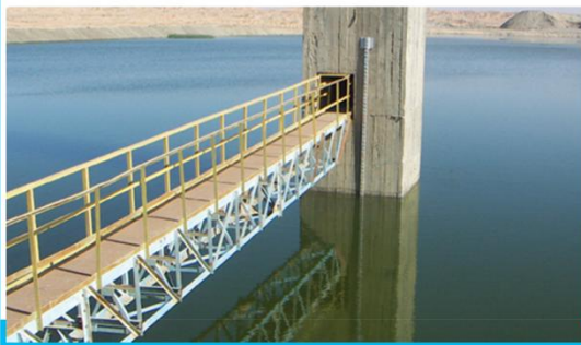
Mdhilla Sludge Bassin
